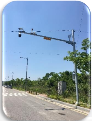
다목적 CCTV 폴(POLE)
